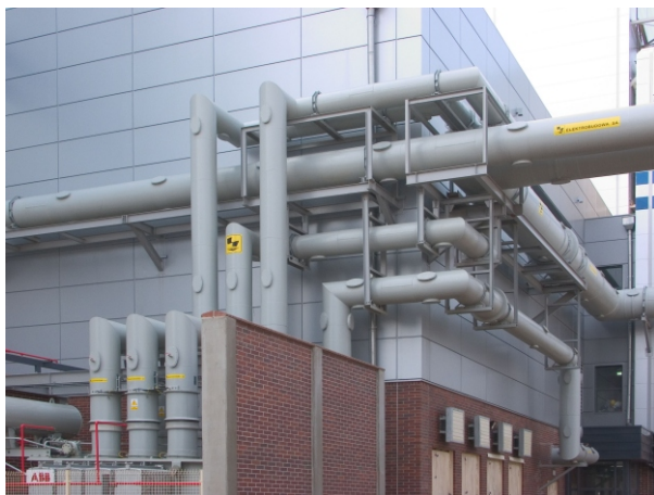
Układy szynoprzewodów w elektrowni Busduct installed in a power station
