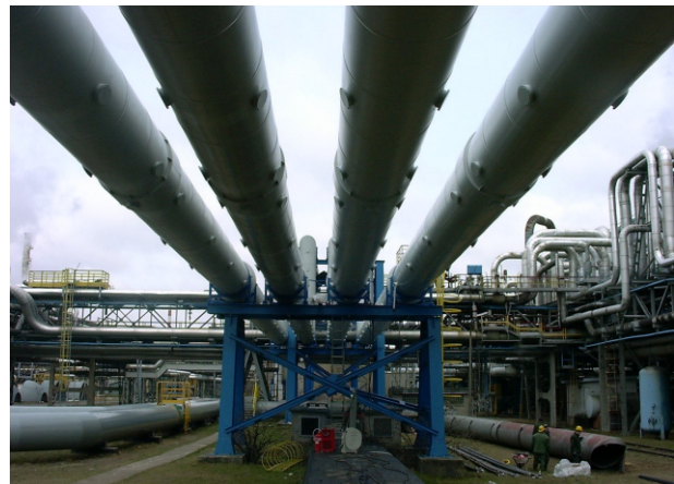
Rozprowadzenie mocy w zakładzie przemysłowym Power distributing system in an industrial plant
